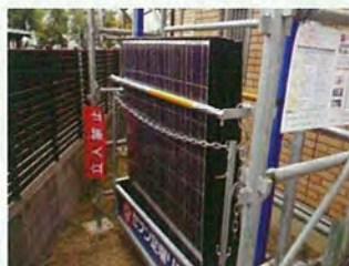
太陽光パネル
